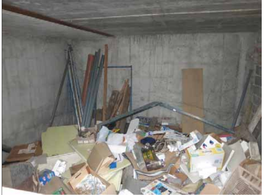
angebauter Kellerraum ohne Tür (älteres Foto durch das Fenster): „Müllhalde“
